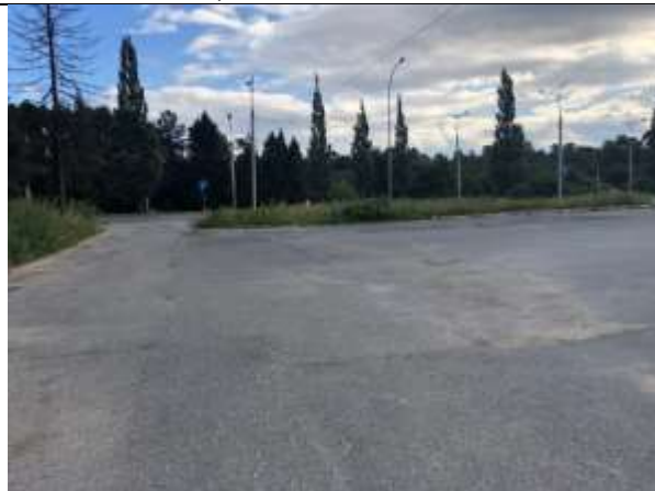
Часть автостоянки на 225 машиномест (Автостоянка на 120 машиномест), назначение: нежилое, площадь 5440 кв. м, количество этажей: 1
